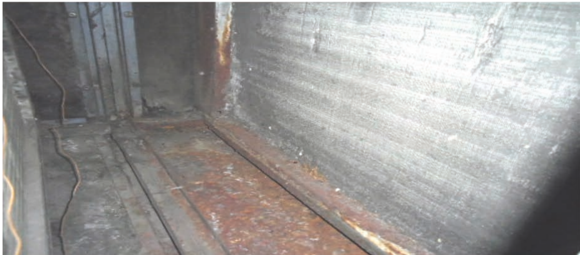
Abb. 3 Oberflächenkorrosion in einem RLT-Gerät
