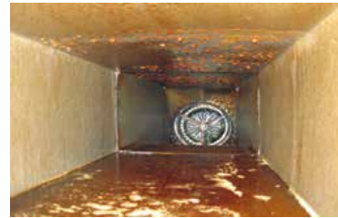
Luftleitung mit Ventilator vor der Behandlung
