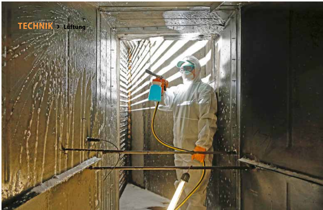
Qualifizierte hygienische Behandlung der RLT-Anlage
