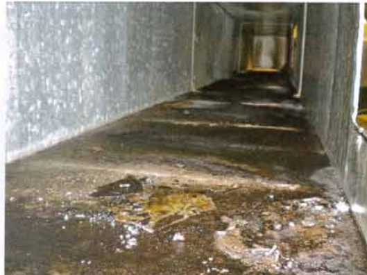
Deutliche Verschmutzung in einem Luftleitungssystem
