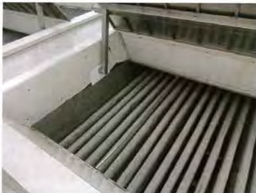
Abluftauslass des Rückkühlwerks nach der hygienisch-technischen Behandlung
