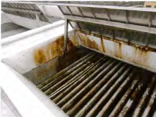
Starke Ablagerungen am Abluftauslass eines Rückkühlwerks
