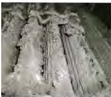
Stark verschmutztes Register einer RLT-Anlage
