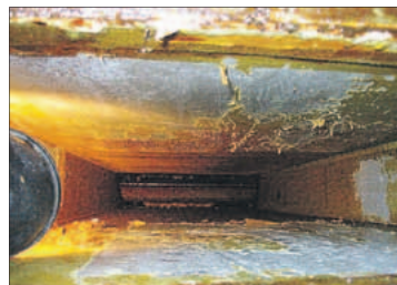
Ein völlig verfetteter und verharzter Luftkanal birgt ein Brandrisiko. Innerhalb weniger Tage kann der Kaminkehrer die Schließung der Küche anordnen. Gesec geht gegen hartnäckige Verklebungen mechanisch vor und schneidet dafür, was nötig, Revisionsöffnungen. Foto: Gesec
